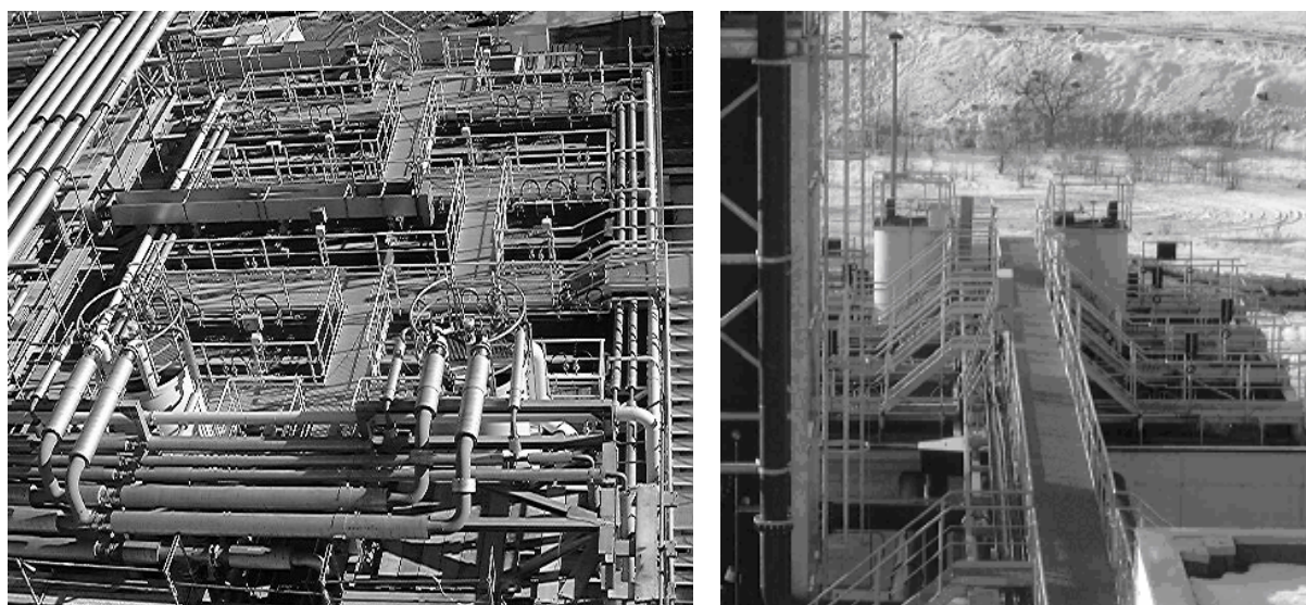
Abb. 2: Ansichten der Neutralisationskaskaden in den HDS-Anlagen der WISMUT in Königstein (links) und Ronneburg (rechts) – jeweils vierstufig in zwei Straßen.
