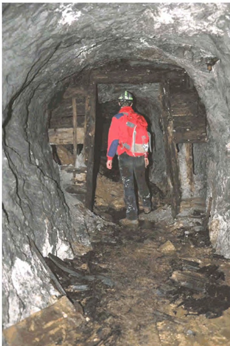
Abb. 15: Vermoderte Wettertüre im Hermann-Stollen.
