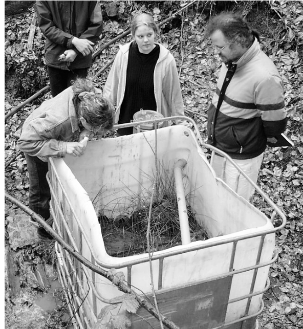
Abb. 2: Teil einer RAPS-Pilotanlage zur passiven Grubenwasserreinigung im Hagental bei Gernrode/Harz. Angehende Studenten werden in die Grubenwasserproblematik eingewiesen und haben aktiv am Bau mitgewirkt.
